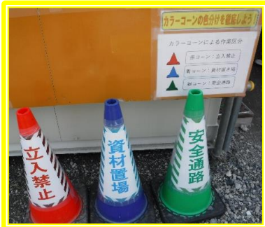
稼働中のクレーンには立入禁止措置がとられています。
