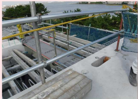
床版の端部には飛来落下防止のため幅木を設置し、近くには資材を置かないようにしましょう。
