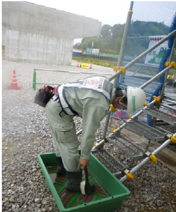
靴底をきれいにするためにブラシ等も設置されていました。 現場をきれいに保つための心配りがなされていますね！
