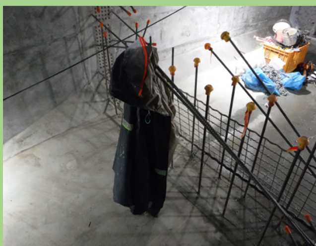
⚠ 桁内部の鉄筋にカップが引っ掛けてありました。見栄えが悪いので片付けるようにしましょう。
