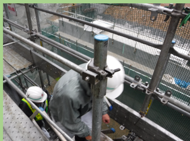
⚠ 昇降階段の上部手摺用クランプネジが飛び出している箇所には、衣類などが引っ掛からないよう保護キャップを使用するかカラーテープを付けるなどで分かりやすくすると良いと思います。
