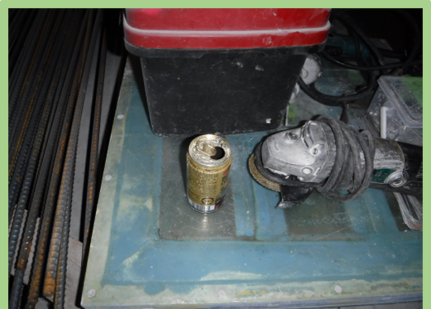
⚠ 喫煙所が数箇所に設置されていますが、桁内部にタバコの吸い殻が入った空き缶がありました。分煙指導を徹底して下さい。
