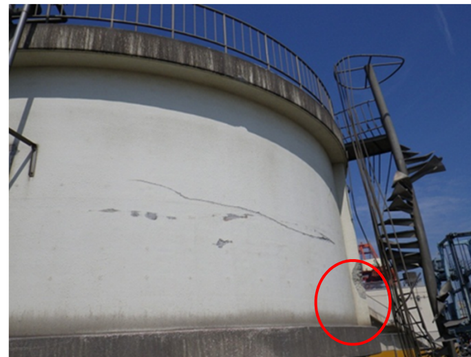
PCタンク定着柱の欠け
